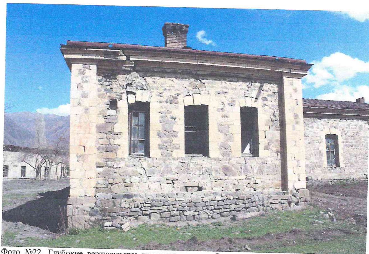
Фото №21. Северная сторона комендантского корпуса, видны глубокие трещины, в оконных проемах отсутствует остекление.
