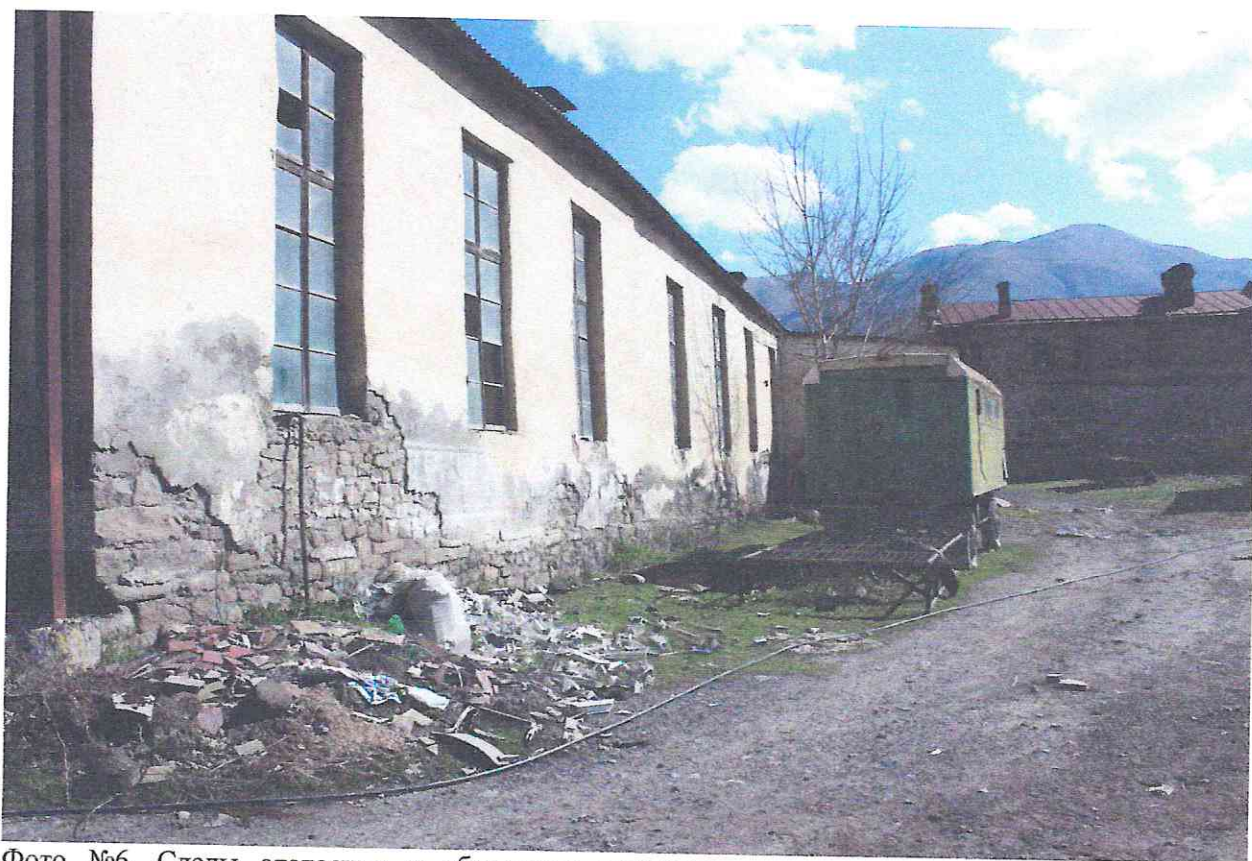
Фото №6. Следы отслоения и обрушения штукатурки и увеличенные оконные проемы в одноэтажной казарме в северо-восточной части крепости (на схематическом плане крепости обозначена №12).
