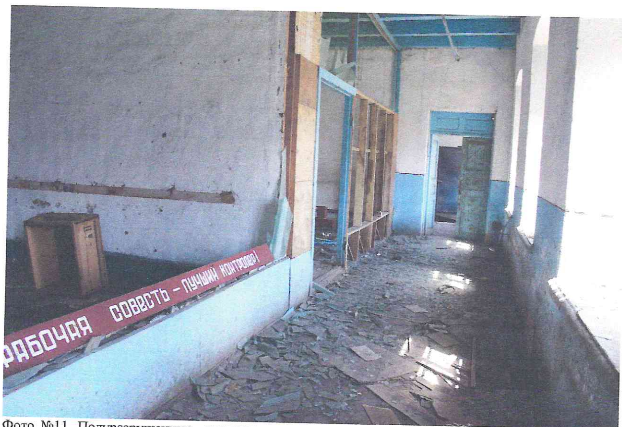
Фото №11. Полуразрушенные внутренние помещения в двухэтажной казарме, в юго-восточной части крепости (на схематическом плане крепости обозначенной №5).
