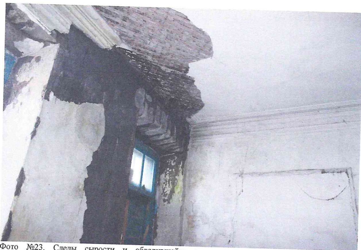
Фото №23. Следы сырости и обвалившейся штукатурки во внутренних помещениях комендантского корпуса.
