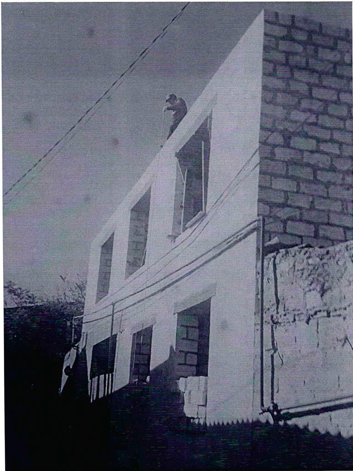
Фото №1. Объект не завершеного строительства по адресу, г.Дербент, ул.2 магал, квартал, 96, дом №6, в зоне регулируемой застройки, регламентная территория с режимом «Р2».
