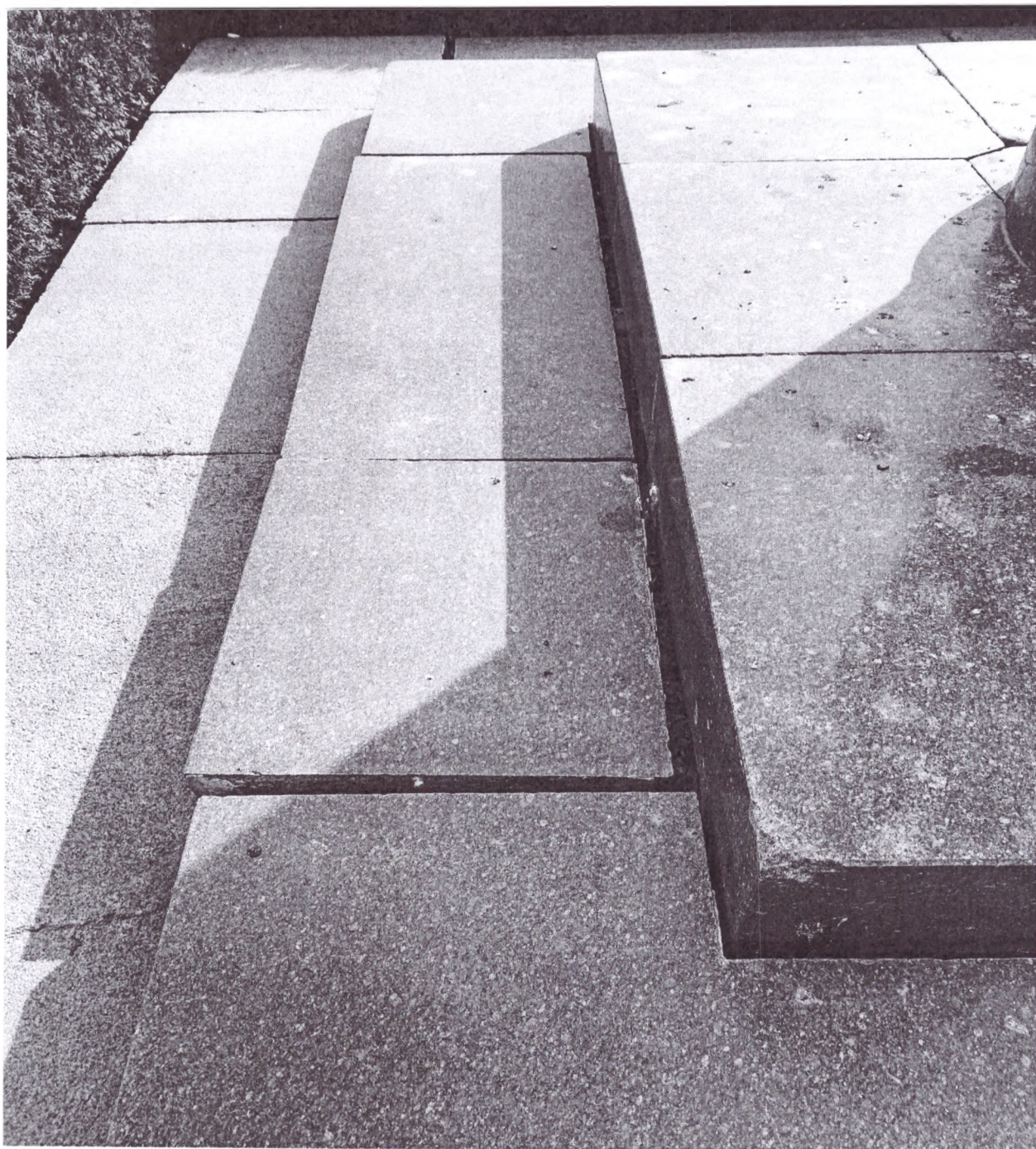
Рис.2 Осадка гранитных плит у основания объекта «могила Стальского Сулеймана (1869-1937 гг.)». Зафиксированы образовавшиеся зазоры между плитами.
