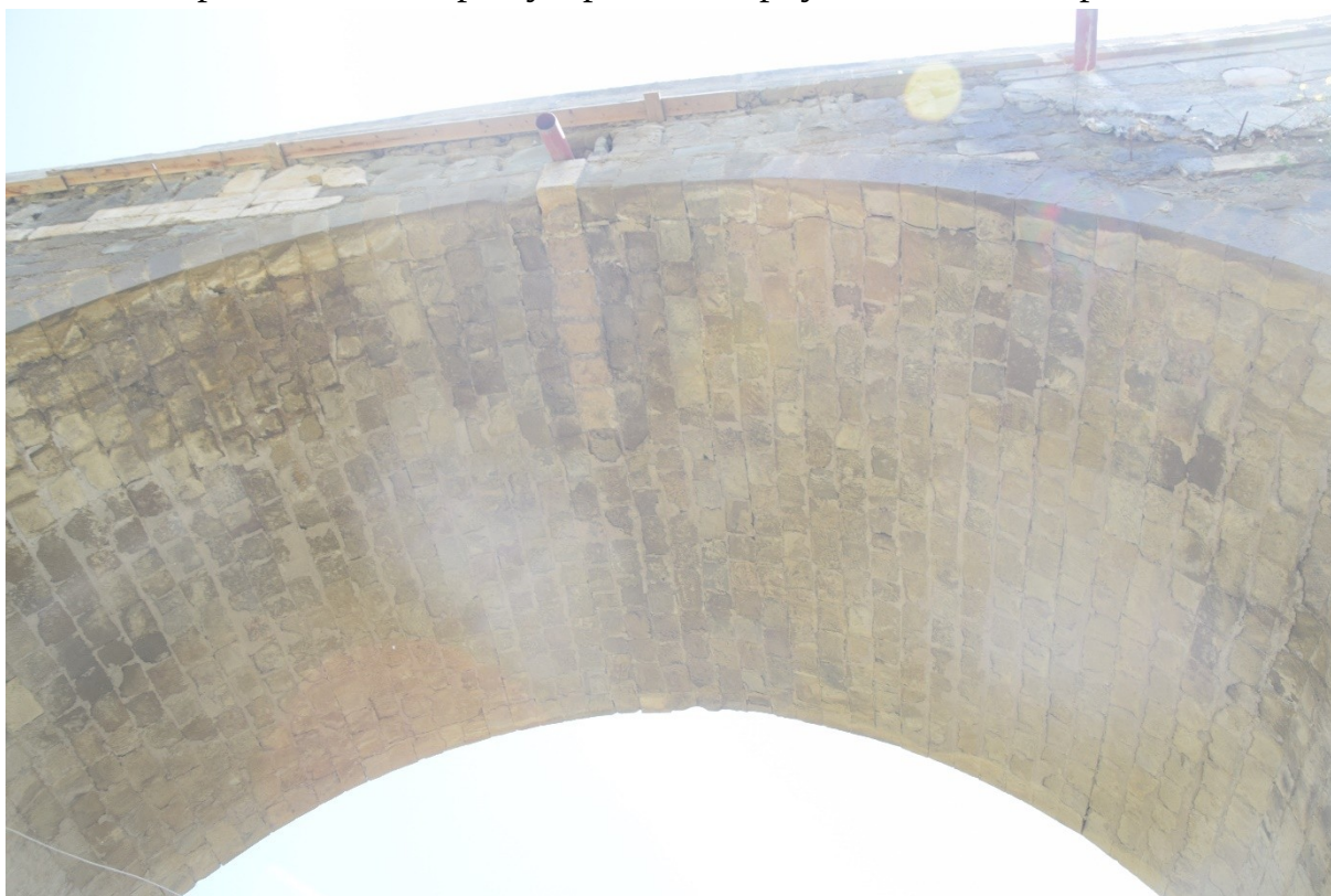
Фото 10. Кладка среднего арочного пролета моста, виден четко подогнанный тесанный камень, устроены трубы отвода дождевых вод.
