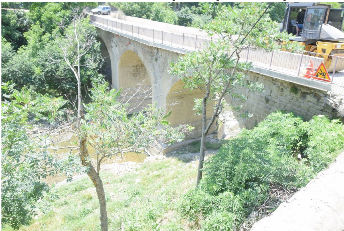
Фото 6. Общий вид на мост с левого берега реки Ханаг-чай, обратная сторона трех пролетов моста и массивных оснований, с этой стороны без волнорезов.
