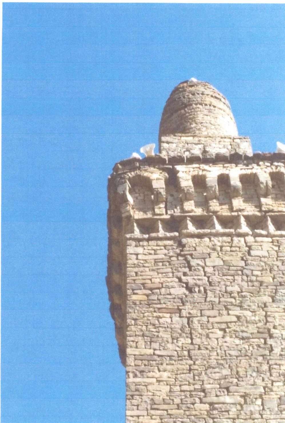
Трещины в завершении ствола минарета. Южный фасад
