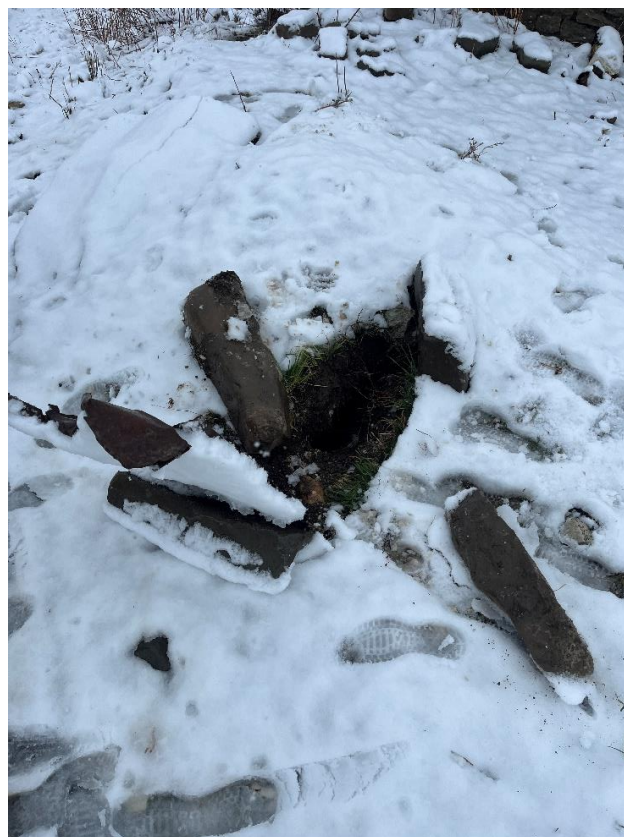
Рис. 3. Фото от 28.03.2026 г. Колодец подземного водопровода вблизи Шамхальского кладбища.
