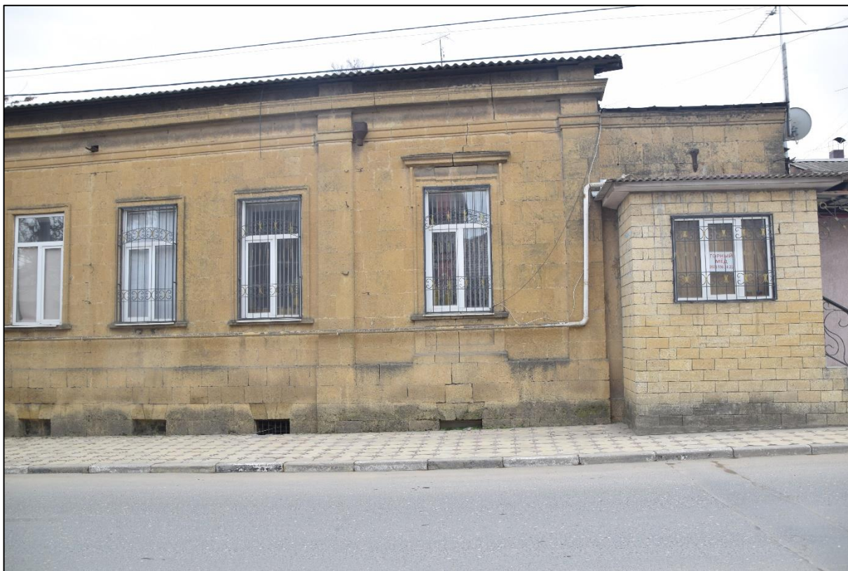
Фото 6. Вид на главный фасад справа, отсутствие парапета над световой осью, бывшей главным входом в здание.
