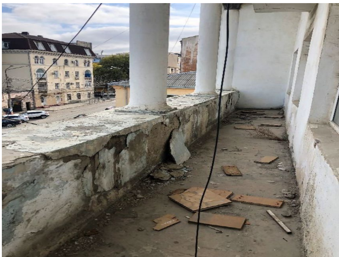
Фото 6. Интерьеры Объекта. состояние балкона на третьем этаже.
