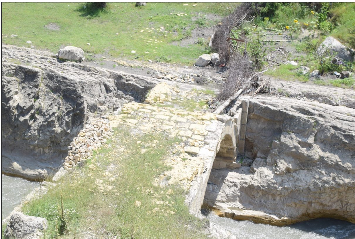
Фото 3. Вид на мост сверху, покрытие не сохранилось, видна кладка арки моста.
