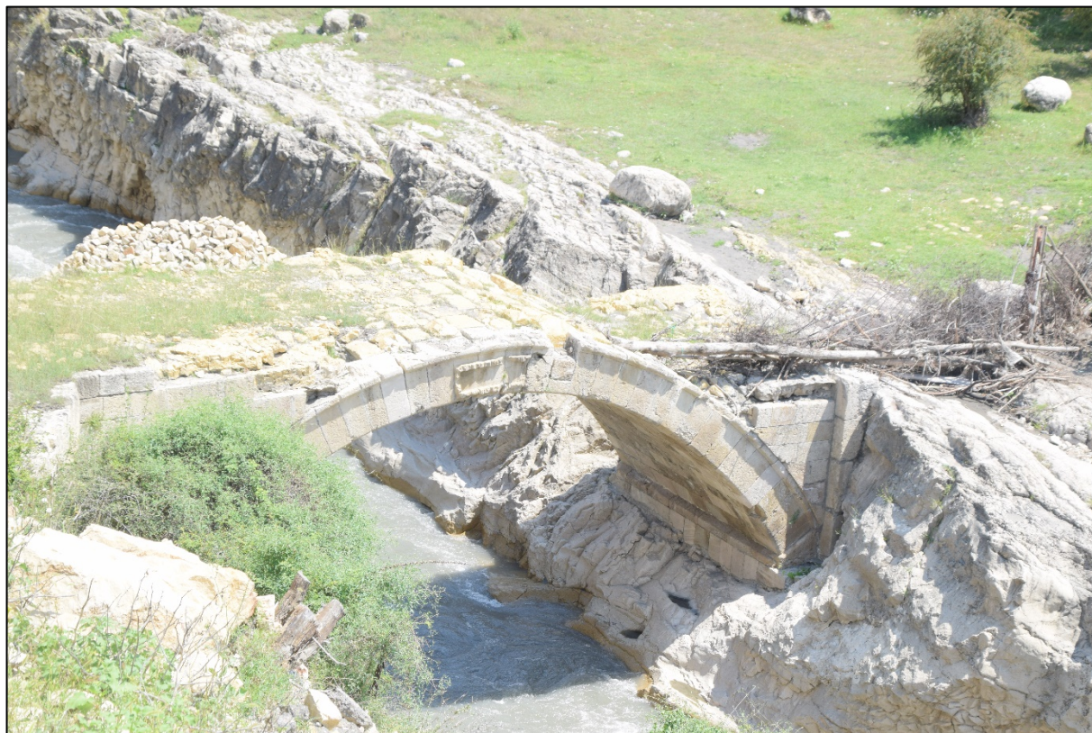
Фото 2. Вид на арку моста, ограждение не сохранилось, пята арки упирается в скалистый берег.
