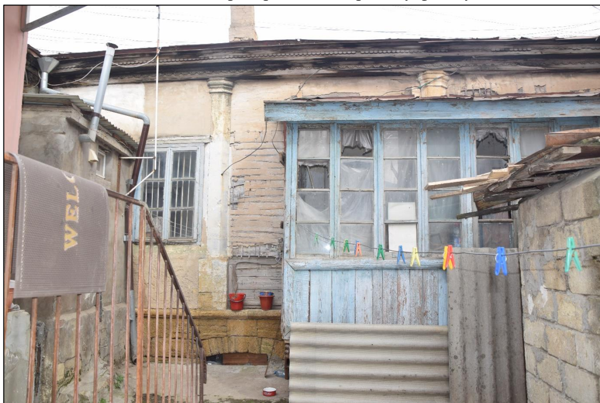
Фото 14. Часть фасада здания с архитектурно-художественными элементами здания, полуколонны и цоколь частично сохранившие свою целостность.
