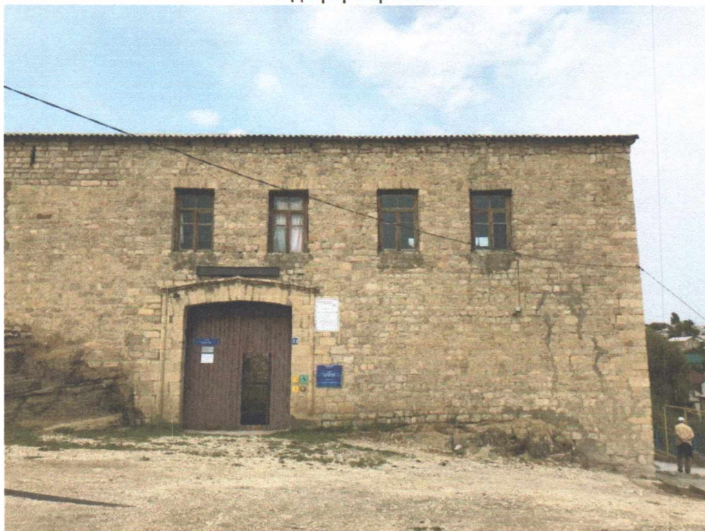
Фото №4. Фасад в осях А/5-12. Выполнен ремонт подоконной кладки. Трещины в клинчатой перемычке и простенке в осях 10-12
