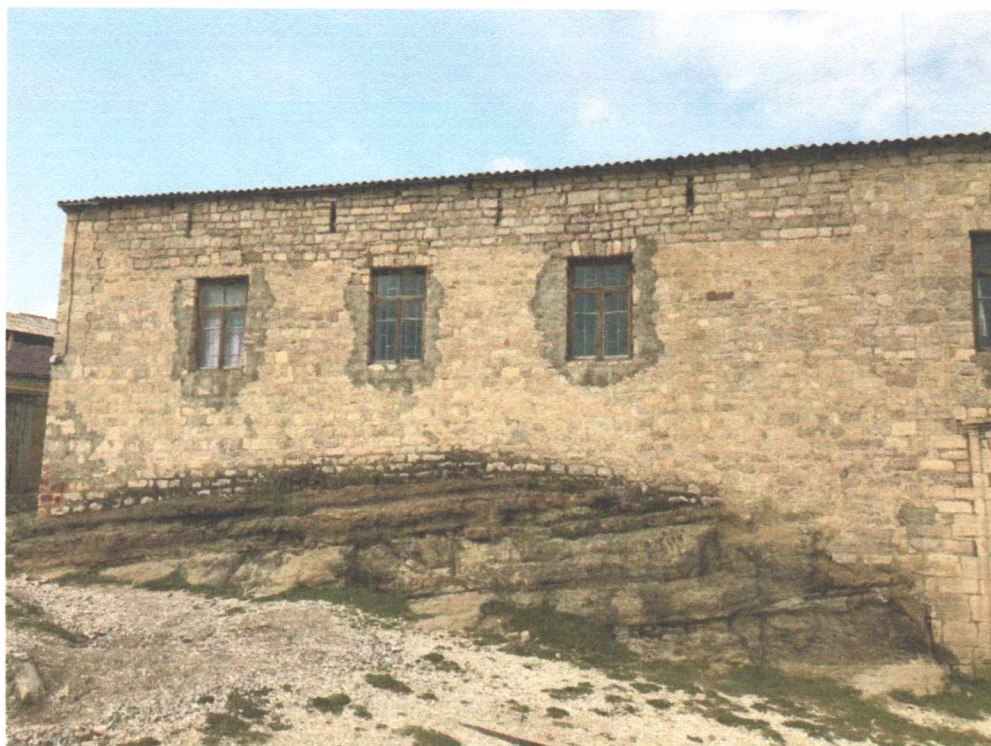
Фото №3. Фасад в осях 1-5. Выполнен ремонт оконных откосов. Клинчатые перемычки деформированы
