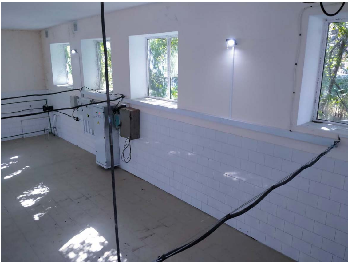
Илл. 37. Фото существующего положения территории объекта. Шкафы управления оборудованием
