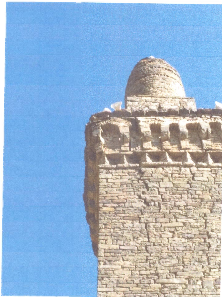
Трещины в завершении ствола минарета. Южный фасад
