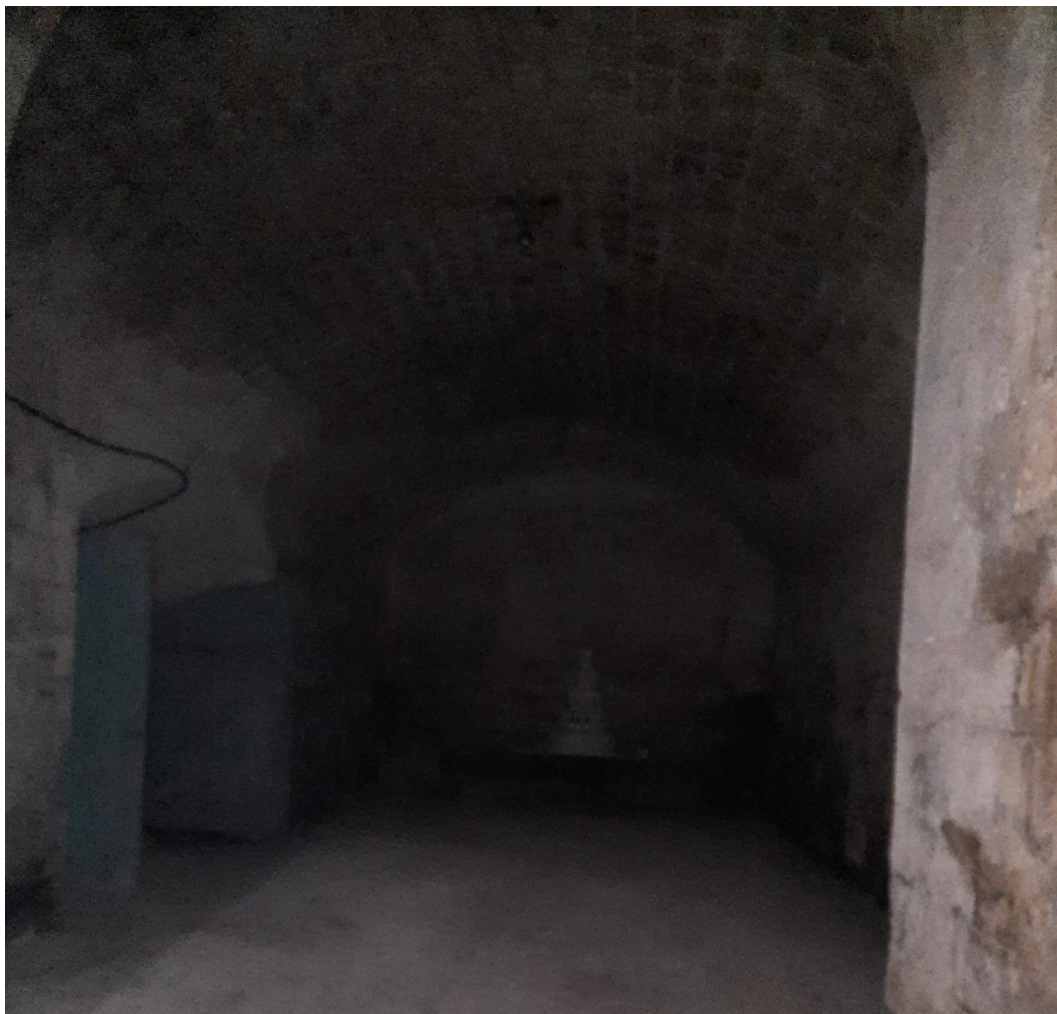
Фото 5. Распределительное помещение в подвале
