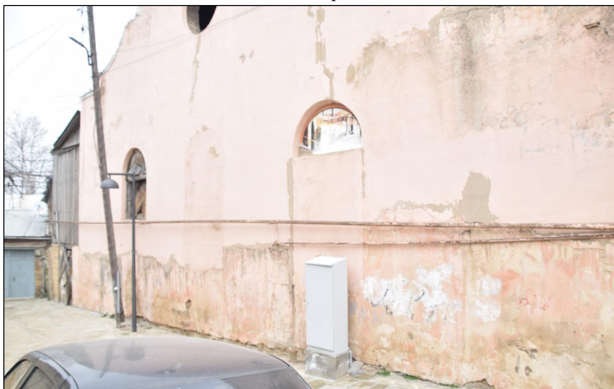
Фото 2. Дворовой фасад здания с заложенными оконными проемами.
